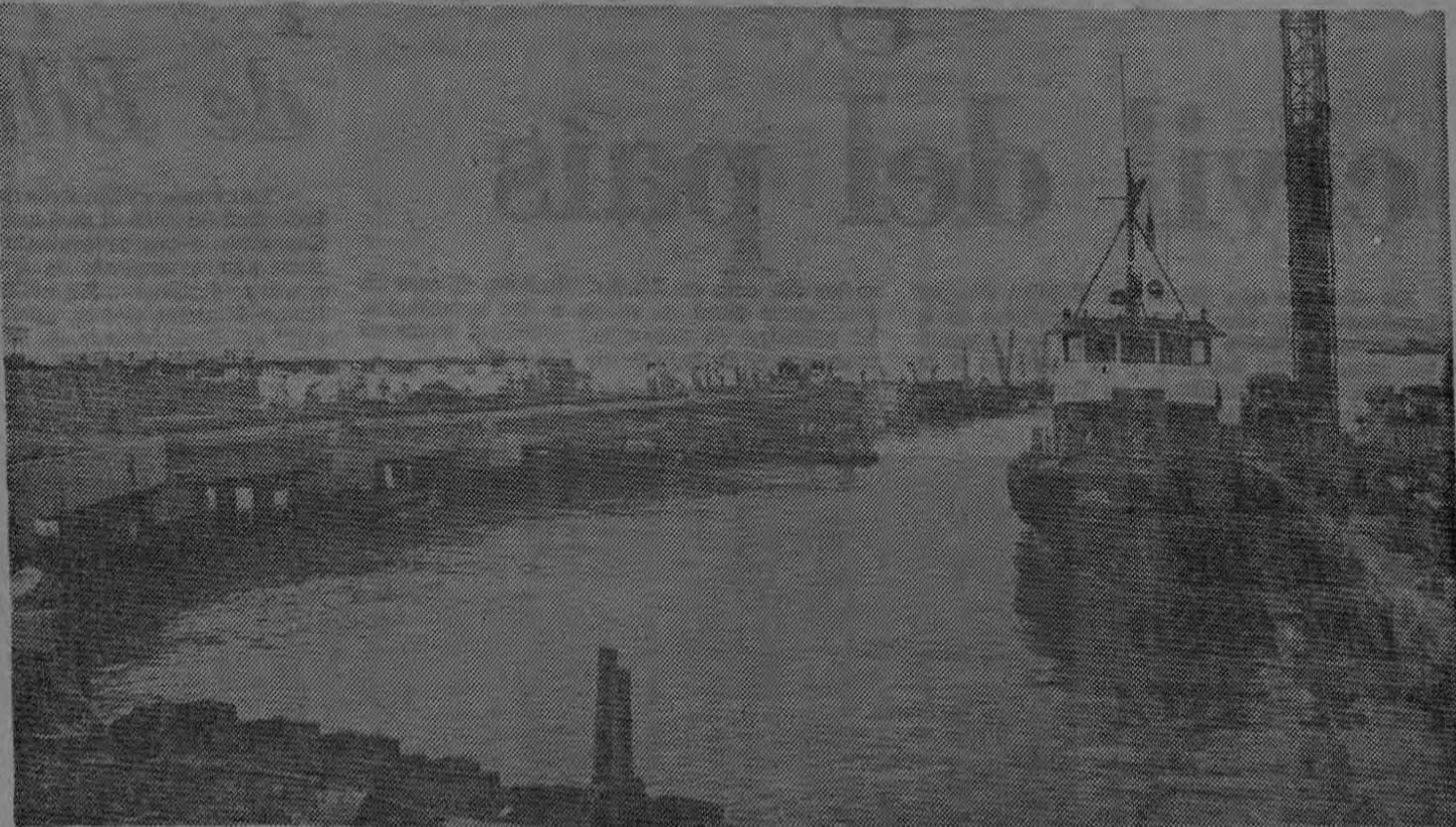
Aproximadamente unos noventa metros en forma lineal es lo que la compañía Protexa de México, ha construido del muelle bananero de Limón. Como se observa en esta gráfica, los tra-
