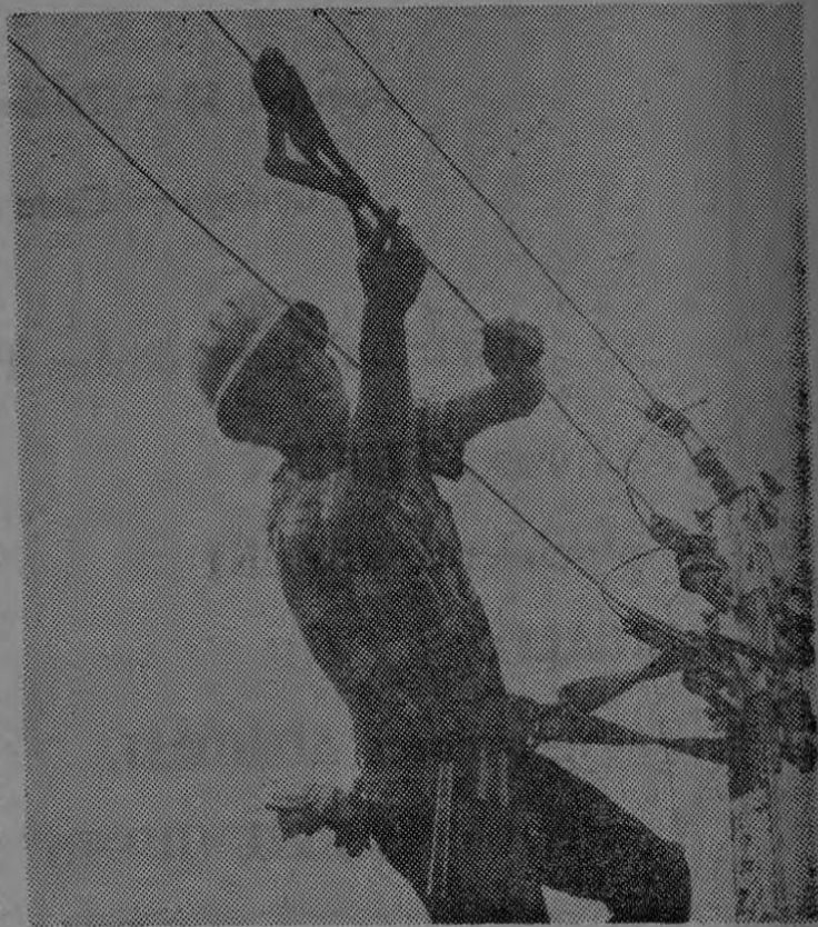
PARA LA ELECTRIFICACION RURAL de la Provincia de Cartago que efectúa la JASEC, mediante un proyecto BCIE y esa institución se ha urgido al cambio radical del sistema de líneas de distribución, labor que se inició en el mes de enero de este año.
